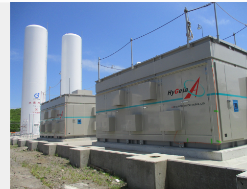
新水素発生装置
