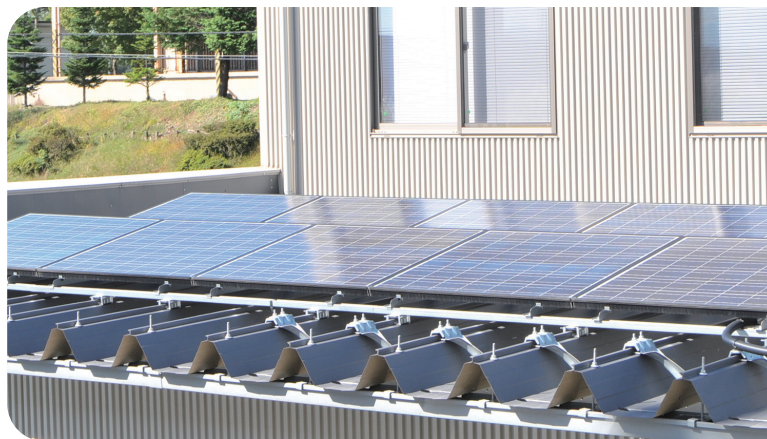
東邦岩手(株)設置太陽光パネル
