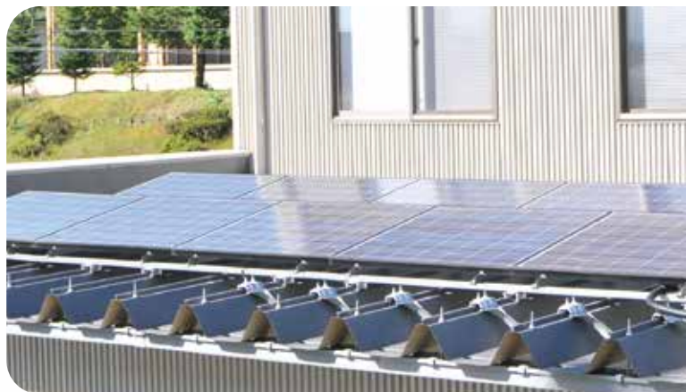
東邦岩手(株)設置太陽光パネル
