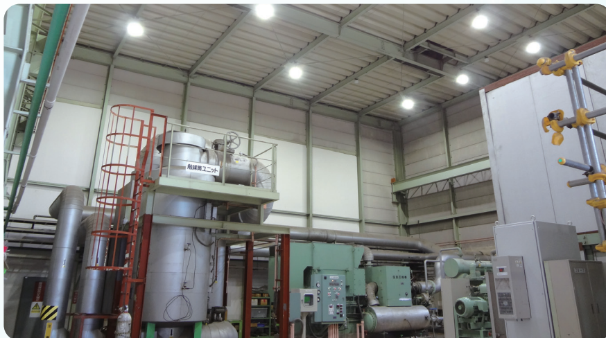
LED照明(多賀城工場液化ガス製造課)
