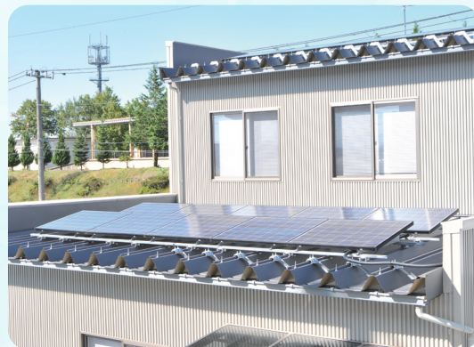
東邦岩手(株)設置太陽光パネル
