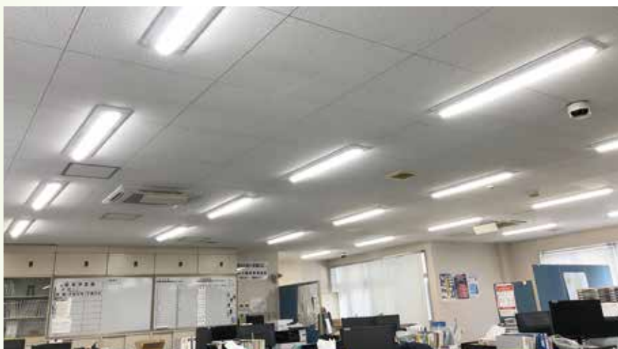
LED照明(八戸事業所)
