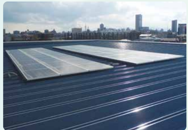
東邦福島(株)設置太陽光パネル
