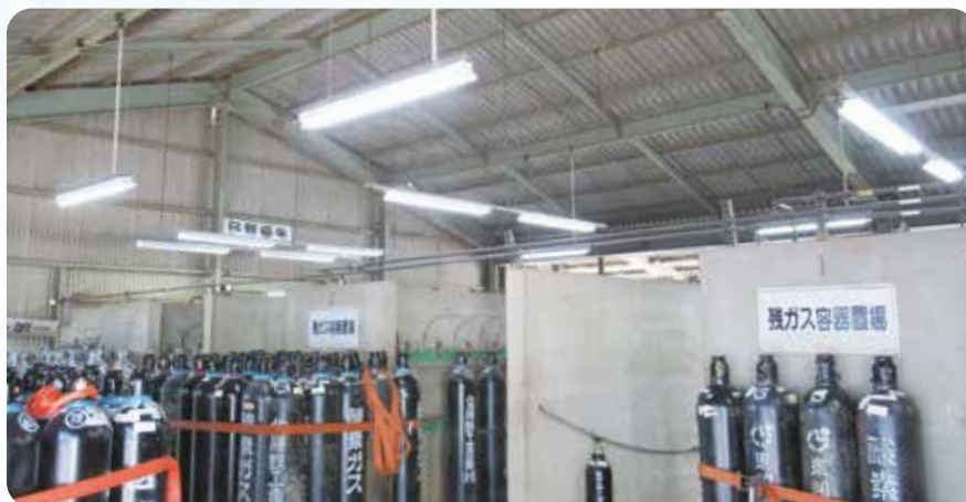
LED照明((株)いわき共同ガスセンター)
